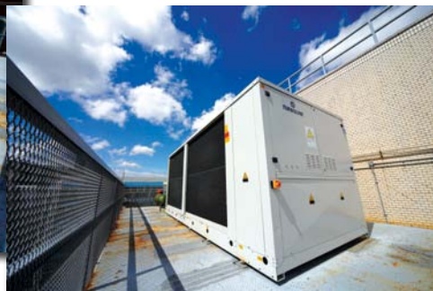
營運基金為建業中心引進的無油離心式壓縮機的製冷機，利用無磨擦磁懸浮軸承技術，為客戶節省能源和維修保養支出。
