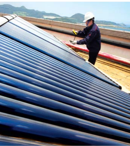
營運基金為東區尤德夫人那打素醫院設計及安裝太陽能熱水系統，提供清潔能源。
