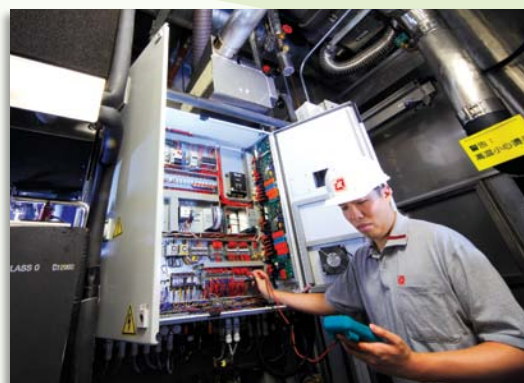
我們為威爾斯親王醫院住院大樓暨創傷中心提供全面的服務，涵蓋機電、空調及屋宇裝備系統的操作及維修保養。
