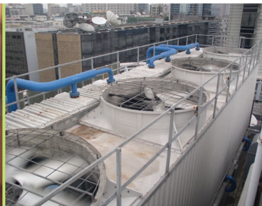
安装于尖沙咀基督教青年会的冷却塔
