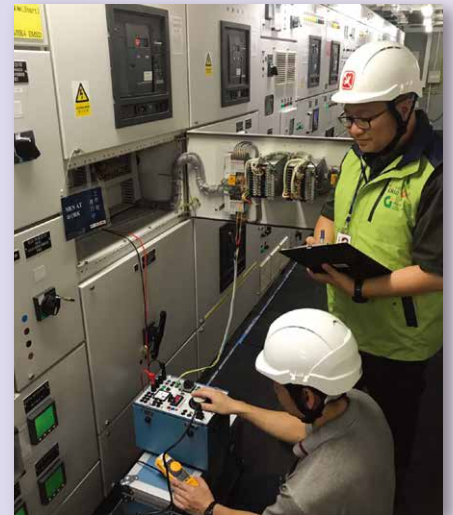
我們為政府總部完成電力裝置檢測，確保相關的電力設備順利運作，保障公眾安全。
