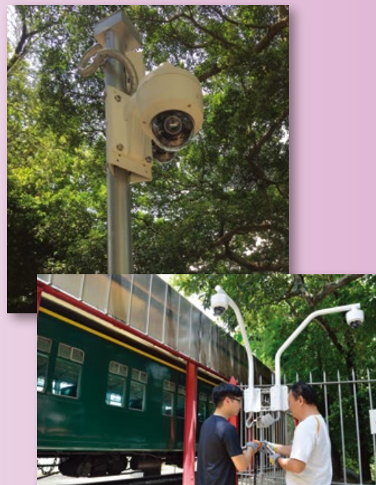
我們在香港鐵路博物館範圍內不同位置安裝了閉路電視攝影機以加強保安。 We installed CCTV cameras at various locations within the Hong Kong Railway Museum to enhance security.
